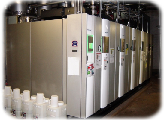
写真② 貫流ボイラー群
