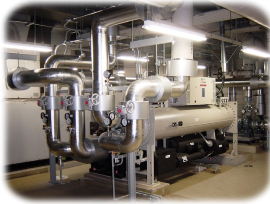
写真① ターボ冷凍機
